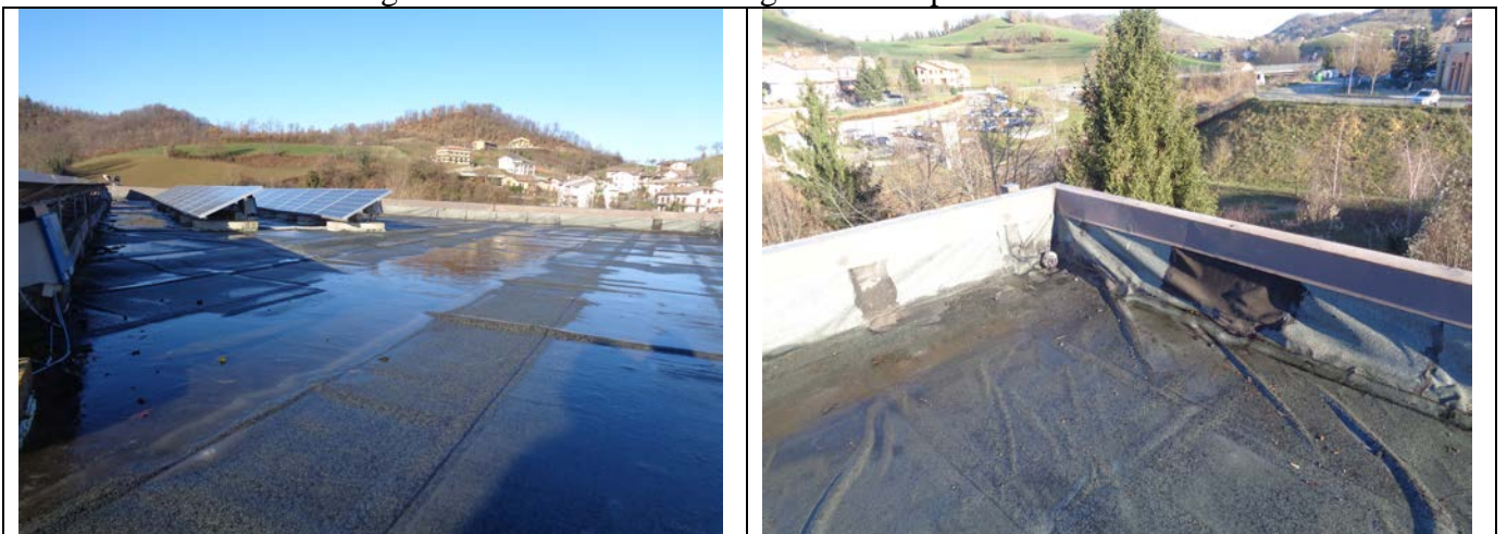
Evidenti fenomeni di ristagno ed arricciamento della guaina in copertura
